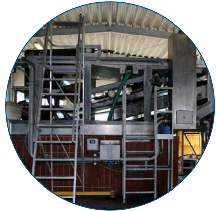
Abb. 8: Bandfilterpresse für Schlamm
